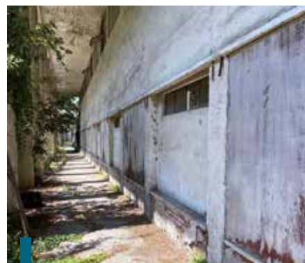
Gli evidenti segni del degrado e dell'incuria di decenni sono ben visibili anche nel corridoio esterno
