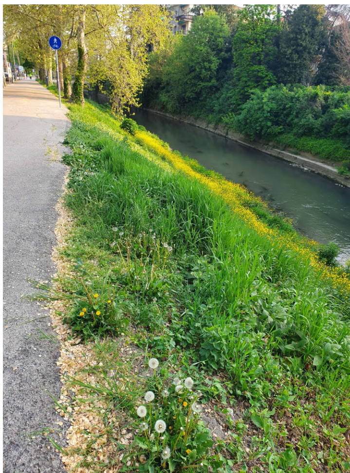
Foto 4 – Tratto di argine molto scosceso, adiacente a ponte Santa Libera, da mettere in sicurezza
