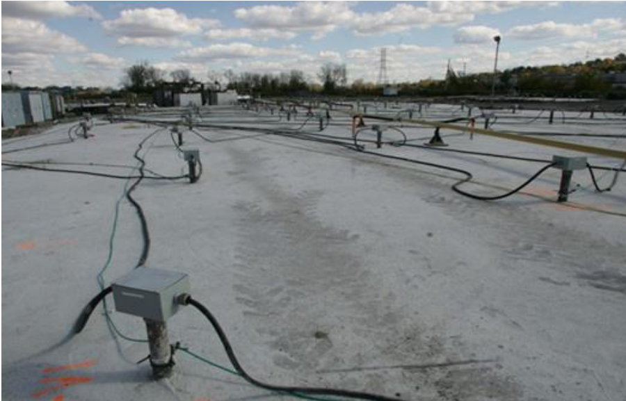
Figura 8: Particolare dell'elemento riscaldante connesso alla rete di distribuzione della corrente elettrica
