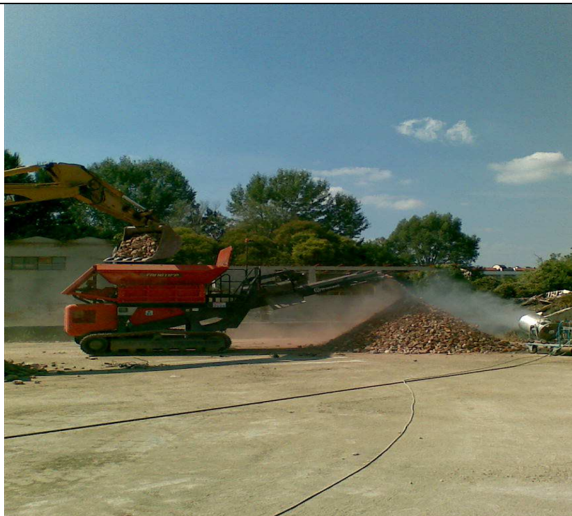
Figura 7.10 : Impianto mobile di frantumazione
