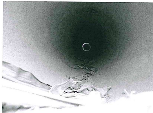
Figura 7: uno dei quattro tubi di scarico a SO
