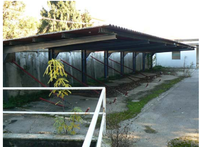
vista 4 - deposito sul muro lato nord
